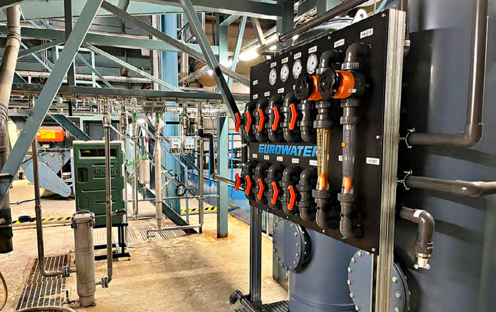
Filterutrustning för rening av dels tungmetaller från processvatten.
